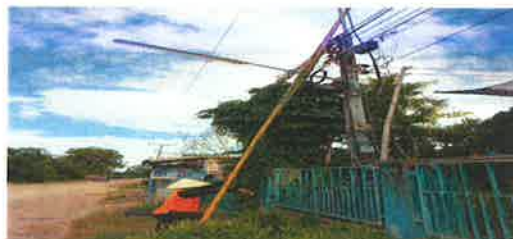
หมู่ที่ ๔ ไม่มีป้ายบนทางสาธารณะ
